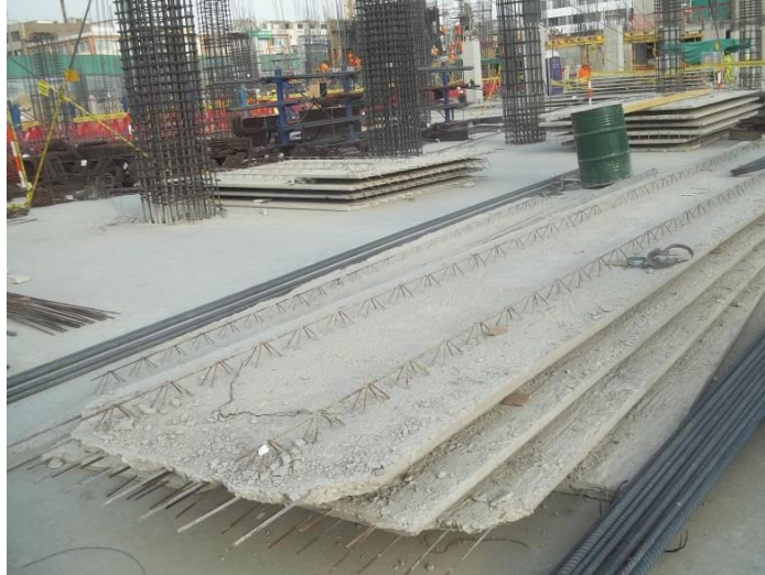
Figura 3.23: Prelosas no aptas para su colocación.
