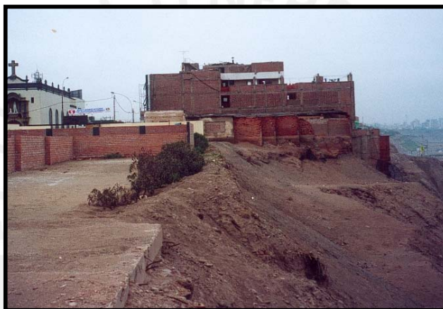
Foto 6.10 Vista de perfil de hotel que tiene sus cimentaciones apoyadas en la corona del talud.
