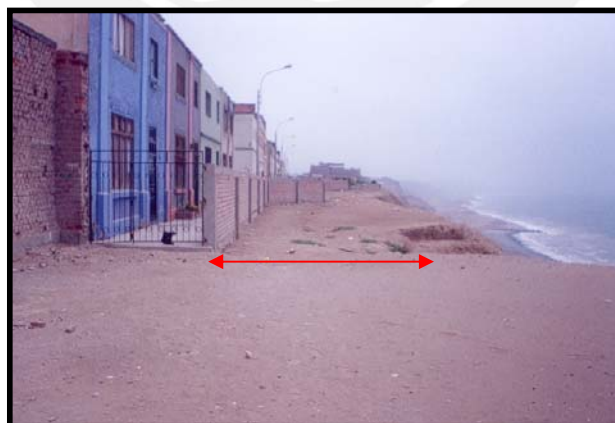
Foto 6.11 Distancia entre el borde de la corona del talud y viviendas ubicadas a la altura de la progresiva 0 + 400.
