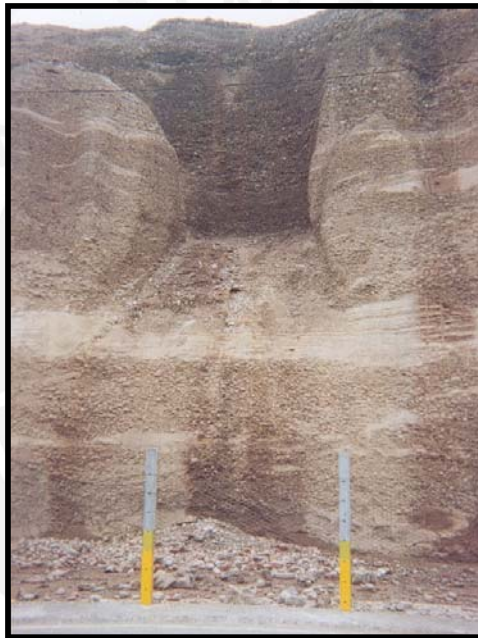
Foto 6.03 Colapso del suelo debido a inundación. Se puede ver que la matriz del conglomerado se separa de las gravas. (Ago. 2002)
