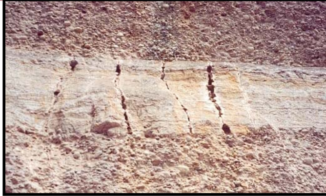
Foto 6.02 Erosión, a manera de surcos, causada debido a intensa garúa (Dic. 2002) El ancho del lente es 2 m. aprox.
