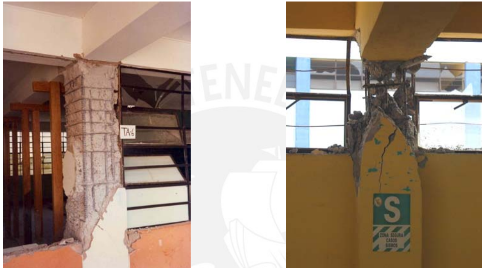
Figura 2.12 Falla por columna corta en edificios escolares tipo 780 pre NDSR-1997
