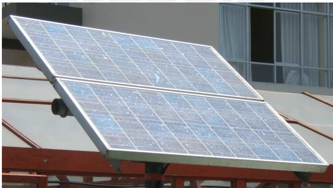
Figura 13: Paneles solares Kyocera LA361J51
