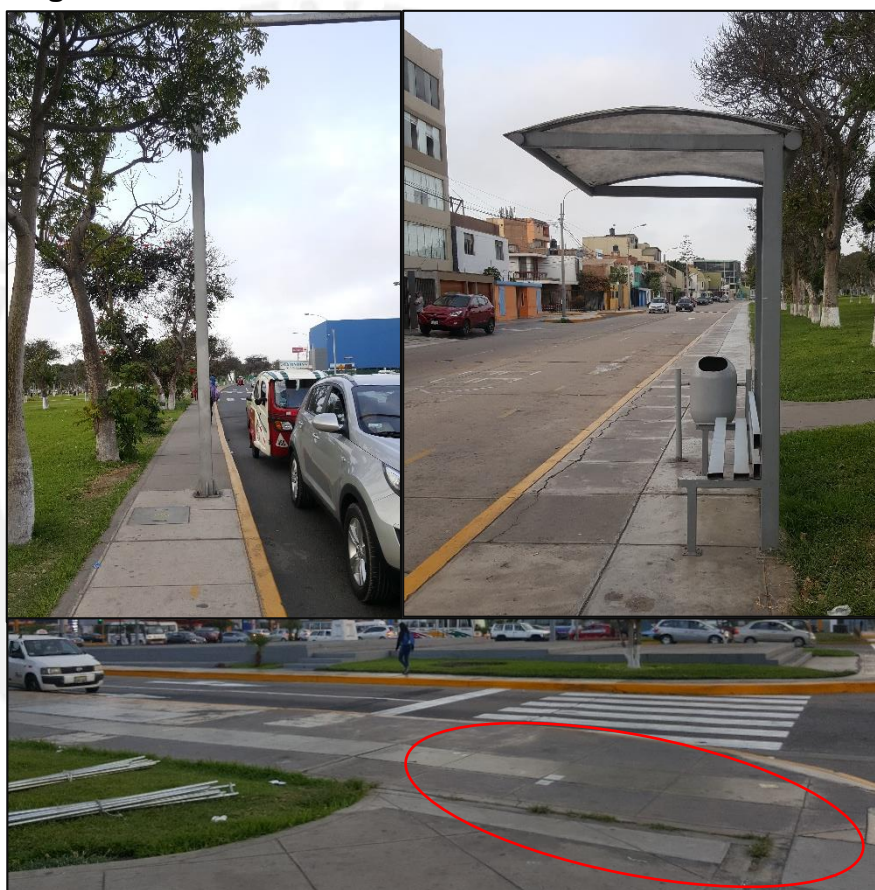
Figura 34: Problemas en las veredas.
