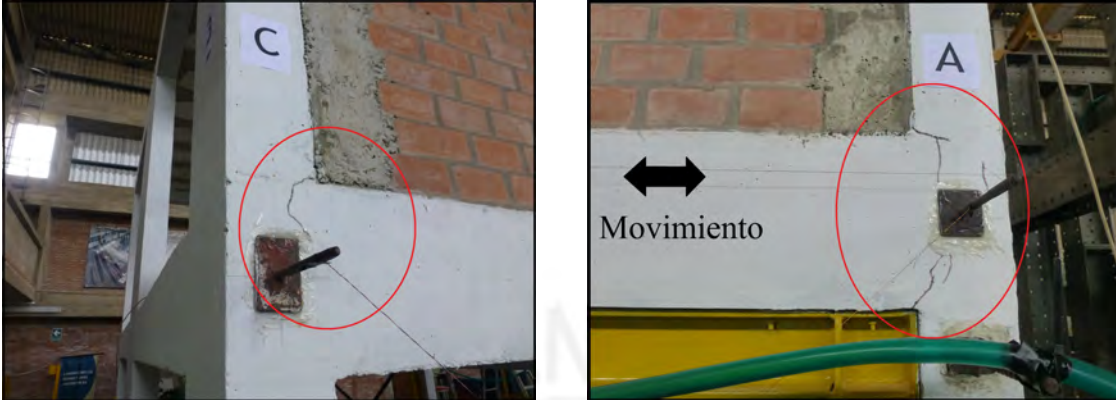
(a) Fisuras en el nudo: entre los ejes C y 3
