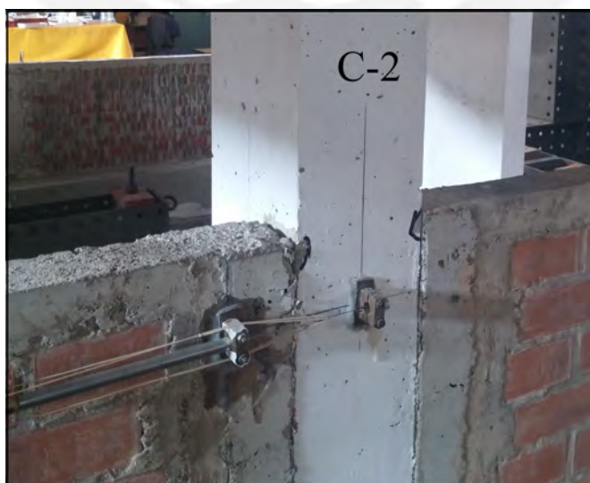
Figura 8.19: Post Fase 2, daño observado en la columna central C - 2 del primer piso
