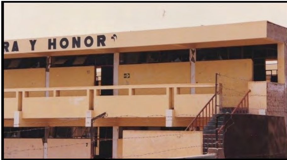
(a) Edificio escolar 780 - Pre, con daños
