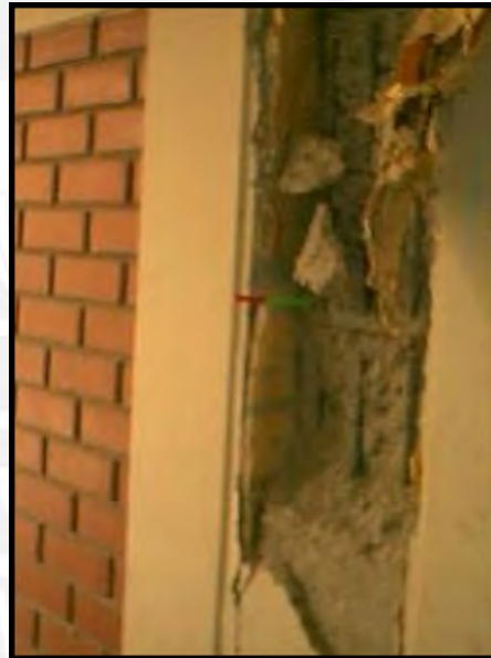
(c) Pérdida de recubrimiento de las barras de acero y junta sísmica inadecuada
