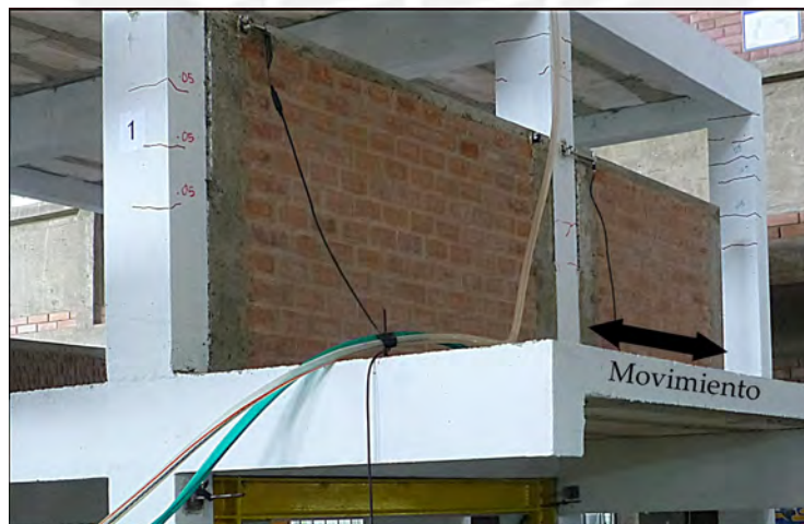
Figura 8.27: Post Fase 3, fisuras por flexión de las columnas del segundo piso del eje 1
