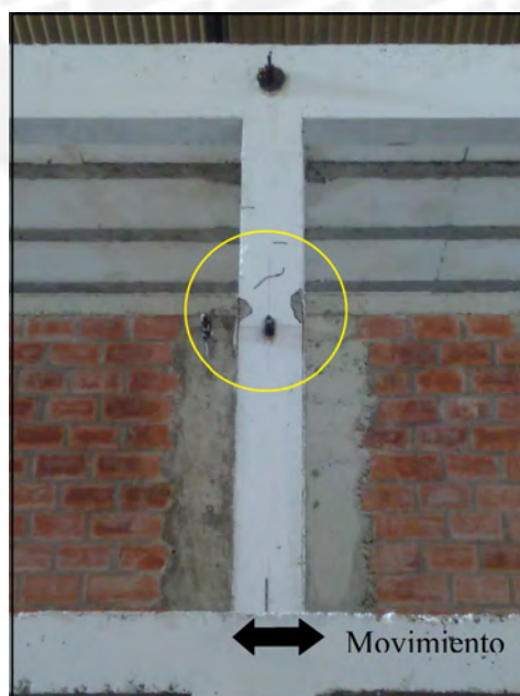
Figura 8.25: Post Fase 4, daño observado en la columna central C - 2 del segundo piso
