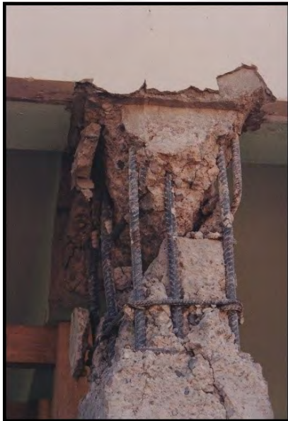
(b) Falla por corte y pandeo de barras longitudinales
