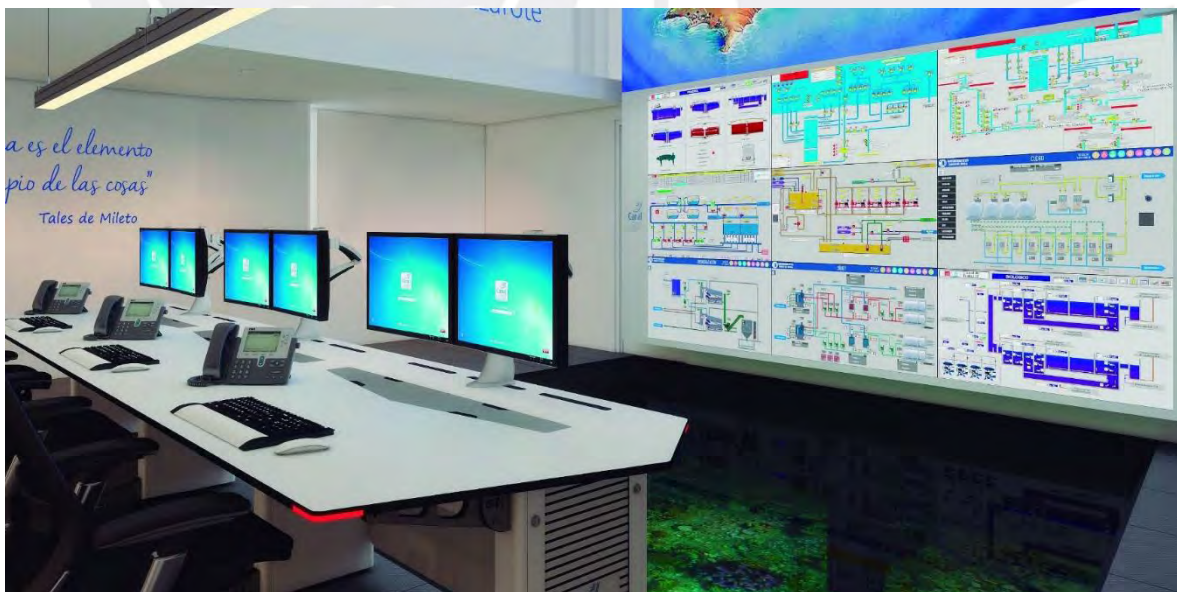
Figura 33. Imagen típica de una Sala de Control Centralizada Tomado de http://www.sice.com/sites/Sice/files/2017-05/V3_IMG_1.jpg
