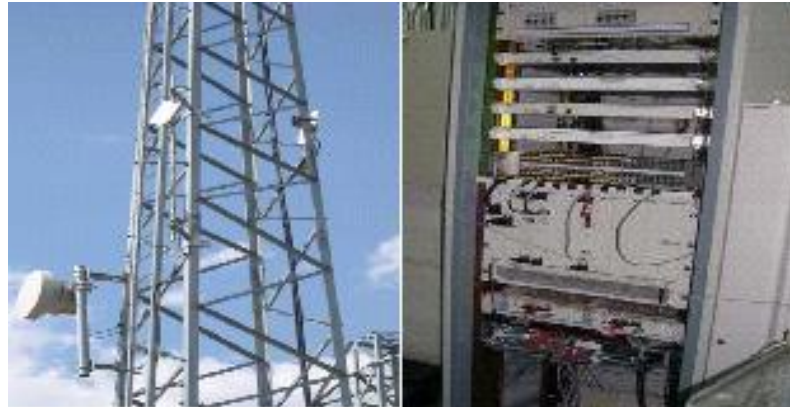
FIGURA 1- 1 Torre y Gabinete de Telecomunicaciones
