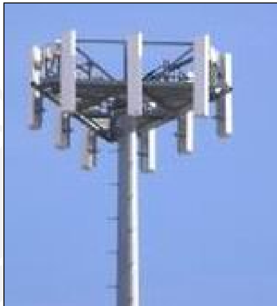
Figura 3.2 Torre de telecomunicaciones II Fuente: Cybertronic (2009)
