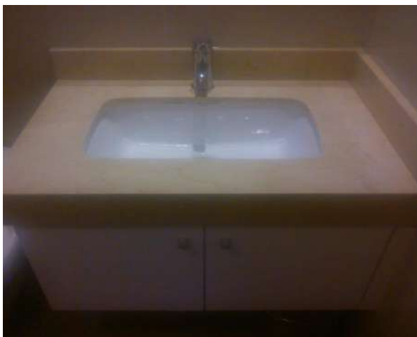
Imagen N° 2: Modelo del lavatorio instalado en los baños principal y común del departamento del denunciante.
