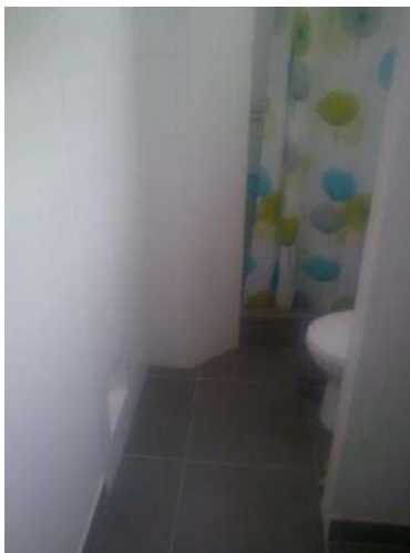
Imagen N° 7: Ingreso del baño de visita, en donde se aprecia la ausencia de puerta.
