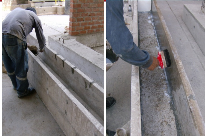
Foto 3.5. Reparación de fisuras con el producto Supermortero de Quikrete® y posterior sellado de poros del concreto con el impermeabilizante Plasticoat.
