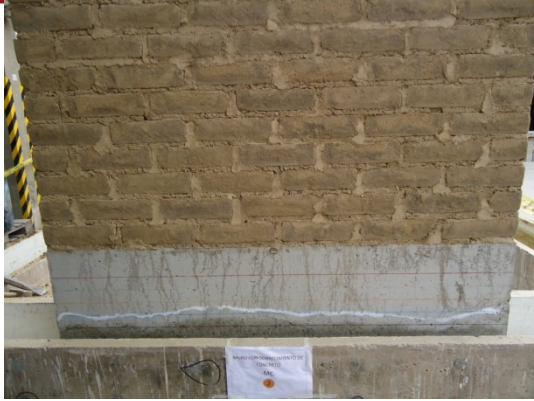
Foto 6.28. Día 16 del Ensayo de Inundación en Muro con Sobrecimiento MC, se aprecia que el ascenso de agua por capilaridad se detuvo en unos 9 cm.
