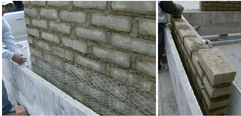
Foto 3.12. Fijación de malla de alambre. Nótese los elementos de anclaje de alambre #8.
