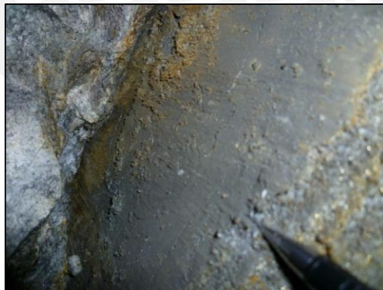
Figura 12 – Plano de falla en la superficie de la roca.
