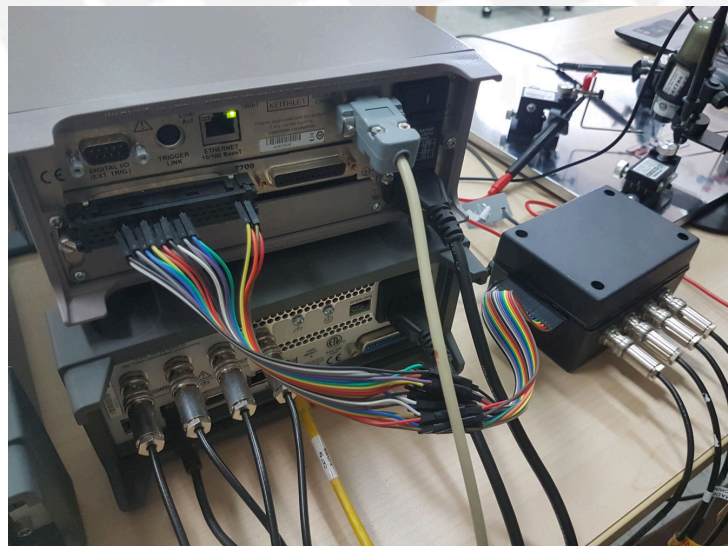
Figura 3.14: Parte posterior del sistema 2 mostrando las conexiones.
