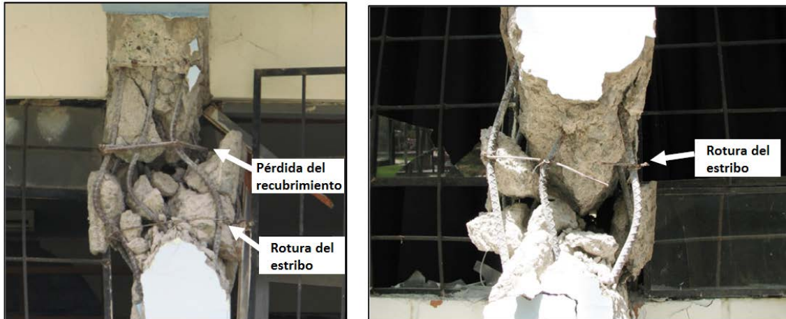
Figura 1.2 Falla típica por columna corta, pérdida del recubrimiento y rotura de estribos [4]
