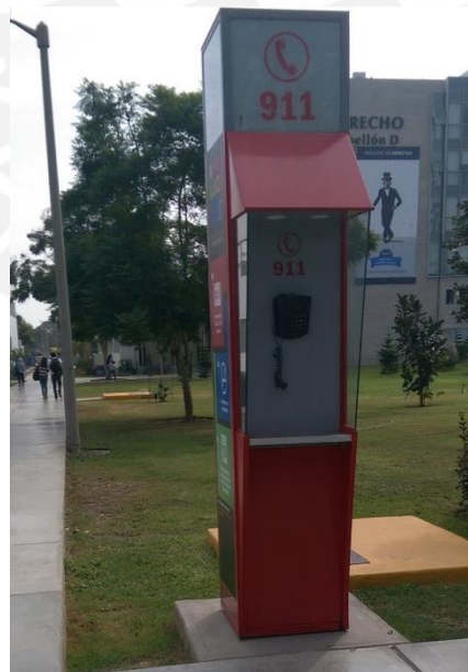
Figura 38. Teléfonos de emergencia para usuarios promedio.
