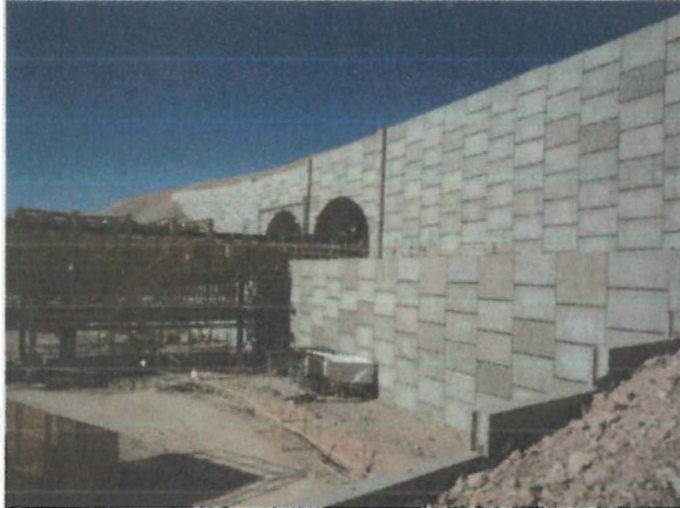
Figura 2-7 Muro de Suelo Reforzado con paneles de concreto prefabricado Fuente: Tierra Armada Internacional
