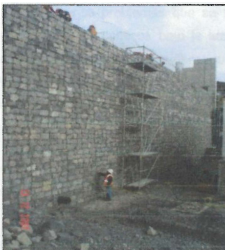
Figura 2-9 Muro de Suelo Reforzado con fachada de gaviones Fuente: Maccaferri de Perú
