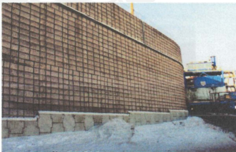
Figura 2-8 Muro de Suelo Reforzado con paneles de malla de acero electrosoldada Fuente: Tierra Armada Internacional
