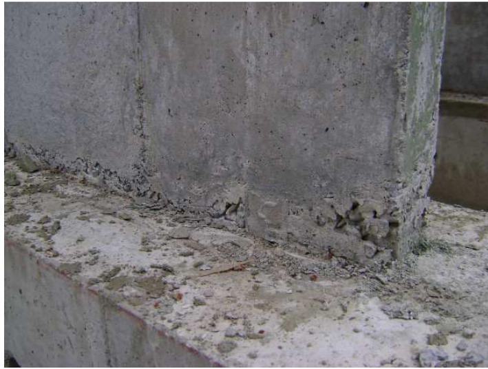
Foto 3.8: Cangrejas en los muros.
