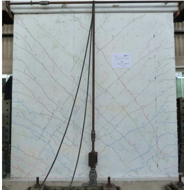
Foto 4.7: Estado Final del muro M-1, Deriva=0.8%
