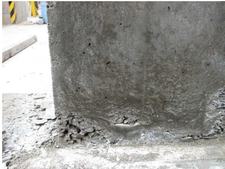
Foto 3.7: Cangrejas en los Muros.
