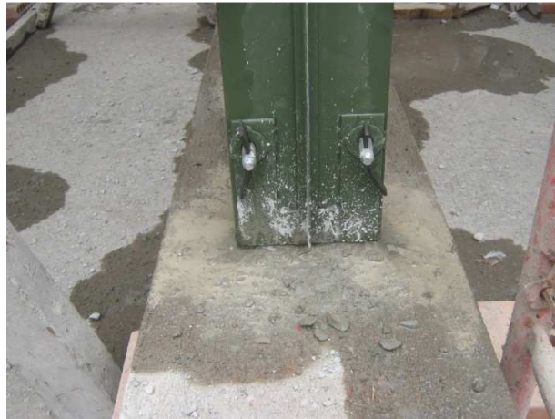
Foto 3.6: Liger fuga de la lechada del concreto.
