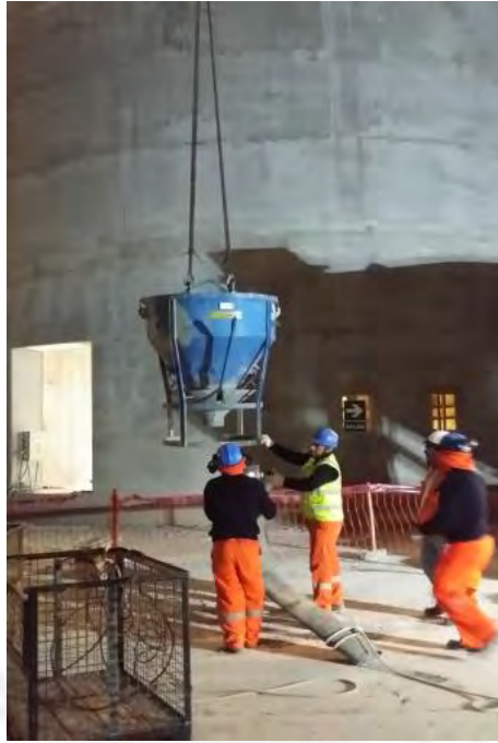
Figura 9.1.- En la figura se aprecia el momento en el que se va a colocar la manguera de jebe en la boca inferior del balde (3)
