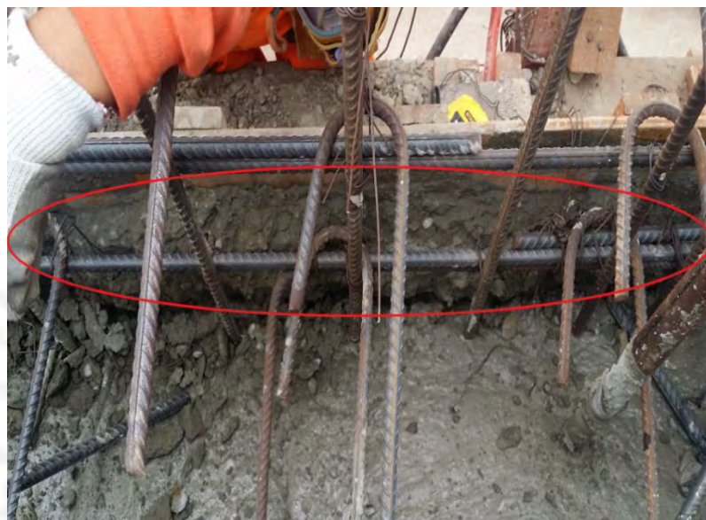
Figura 7.1.- Capa de concreto adherida al molde (3)
