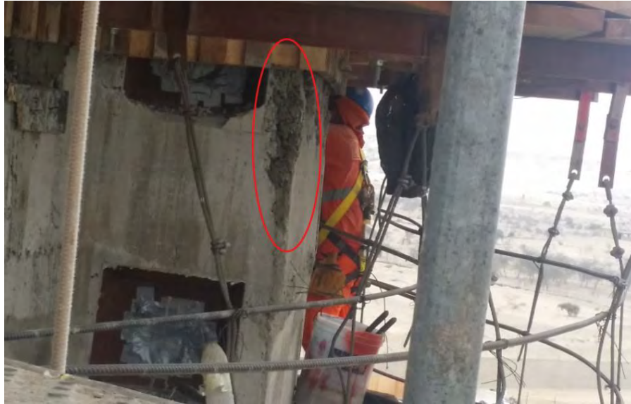
Figura 7.2.- Cangrejera producto de concreto adherido en molde (3)
