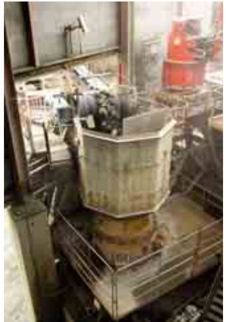
2. Trituradora Nordberg GP500S operando como trituradora secundaria después de una trituradora primaria C160.
