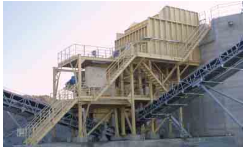
Una C125 durante la fase de instalación en una nueva planta de trituración primaria.
