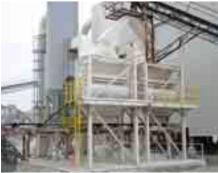
Dos AC27 trabajando en paralelo con una capacidad conjunta de 150 t/h.
