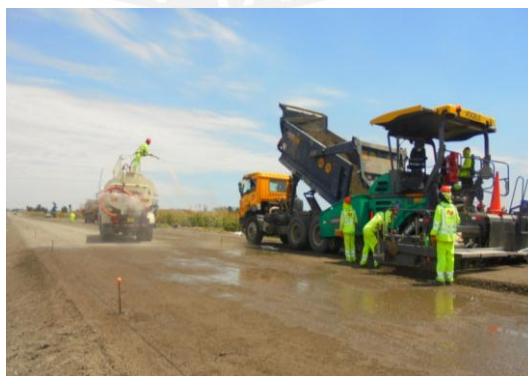
Figura 032. Etapa 3: Humedecimiento de plataforma de subbase para el colocado de la capa de base. Fuente: Propia.
