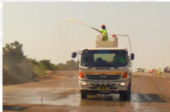
Figura 8. Cisterna de agua.
