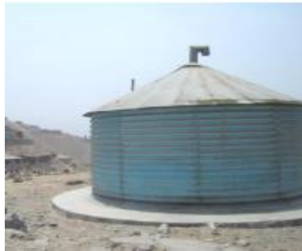
Fotografía 5: Reservorio metálico del sistema de agua. Fuente: SEDAPAL
