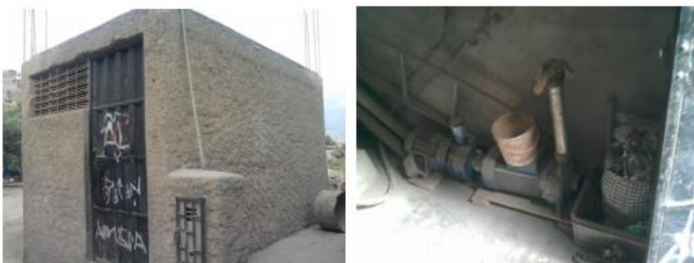
Fotografía 6: Cisterna y cámara de bombeo. Fuente: SEDAPAL
