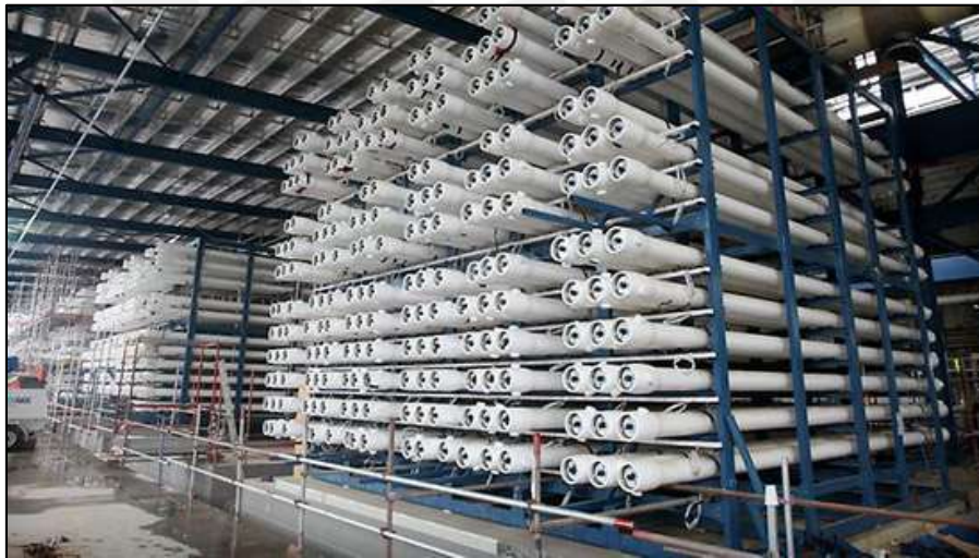
Figura 2.5 Bastidores de osmosis inversa. [7]
