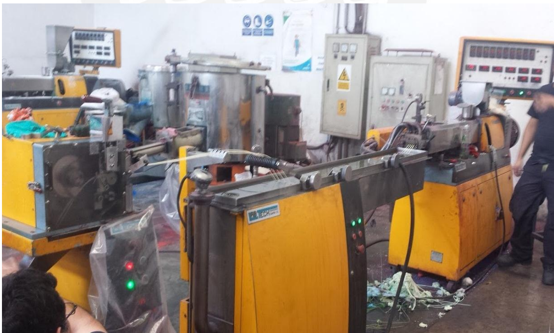
Figura 2.5: Línea de extrusión que comprende la Extrusora la enfriadora por agua y la granuladora
