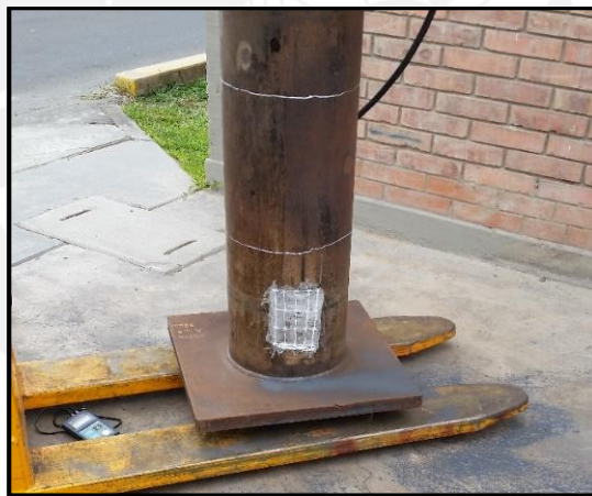
Figura 3.11 - Daño real 1 – LTA
