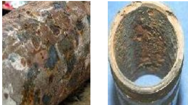
Fig. 1.16 Corrosión por picadura externa e interna
