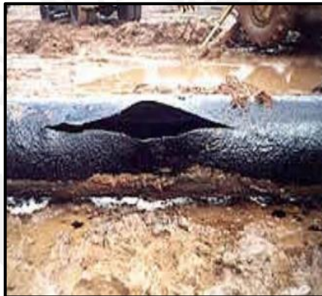
Figura 1.7 Oleoducto averiado por corrosión
