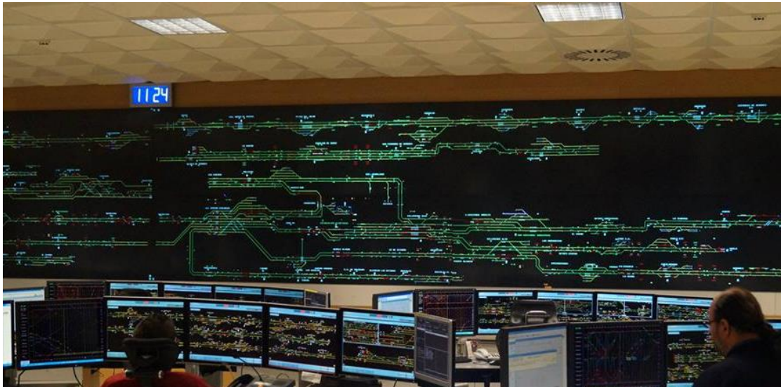
Figura 2.10 Centro de control de Cercanías Madrid
