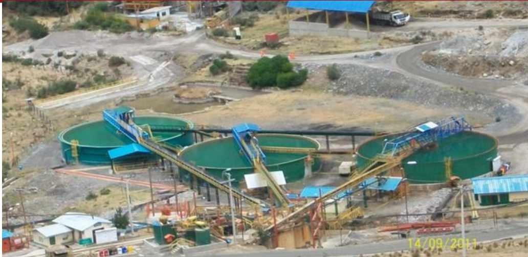
Figura 6: Planta de tratamiento de aguas ácidas
