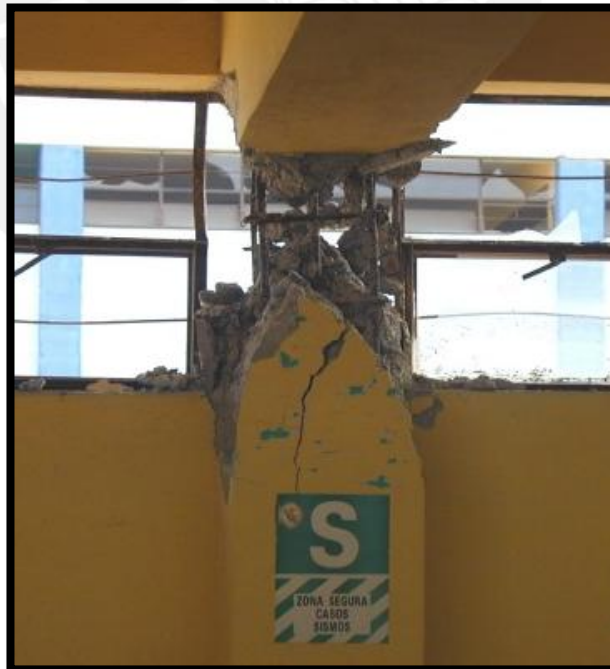
Figura 2.- Falla por columna corta de un colegio en Arequipa (2001). Se observa que la columna que falló era considerada "Zona Segura" según defensa civil
