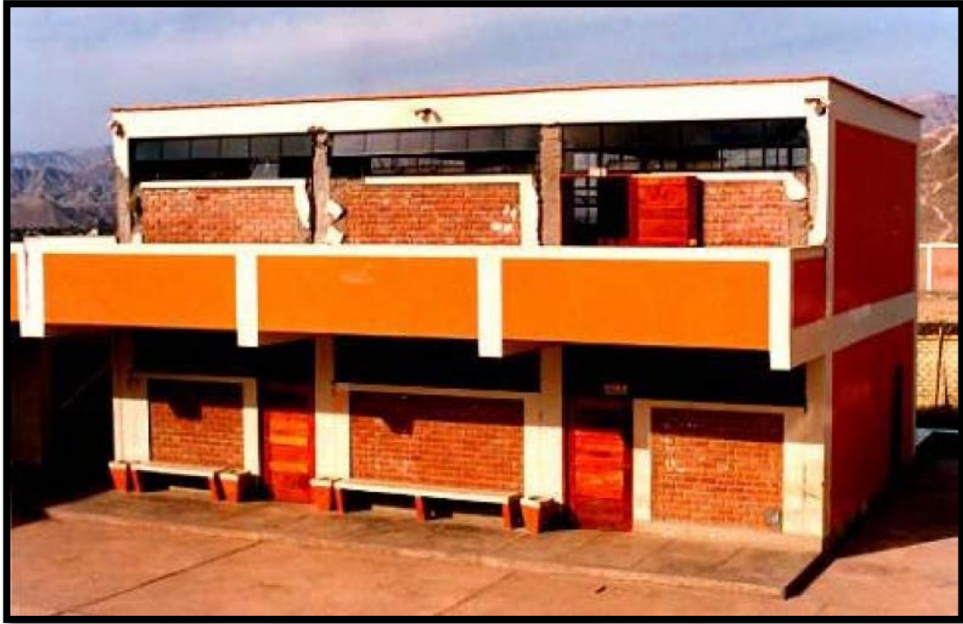
Figura 1.- Colegio Fermín del Castillo, Nasca. Se pueden observar los daños por columnas cautivas en las columnas del segundo piso
