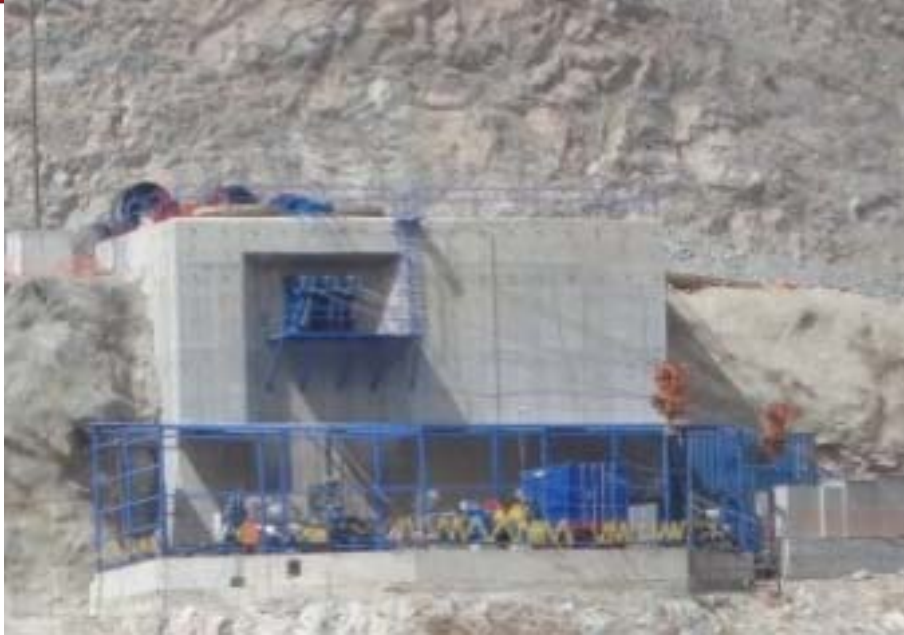
Foto 3.06. Contenedor eléctrico (Fuente propia).
