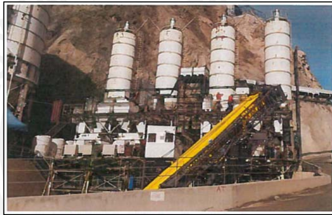
Foto 5.01. Planta de concreto Betonmac (Fuente CRM-CHCDA).
