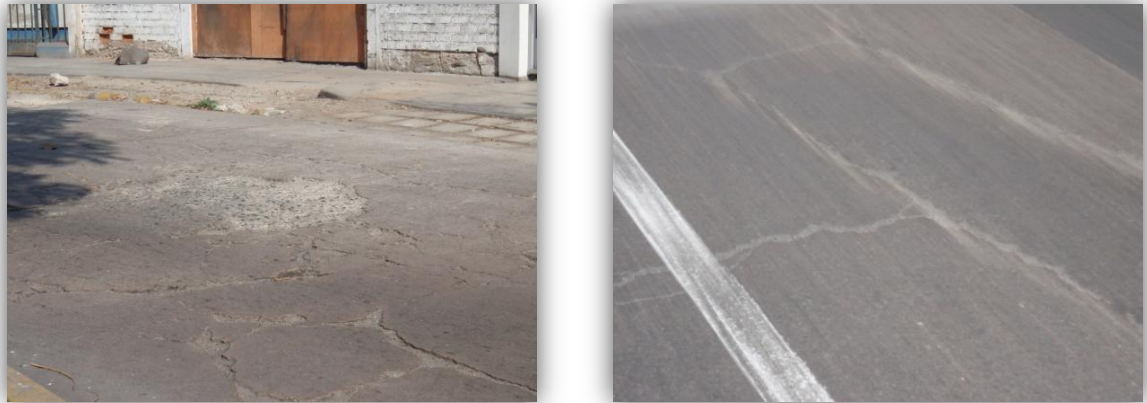
Figura 2.18: Pavimento asfáltico en mal estado (con grietas profundas).
