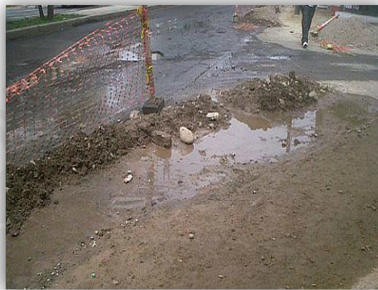
Figura 2.10: Pistas en mantenimiento sin adecuada prevención.
