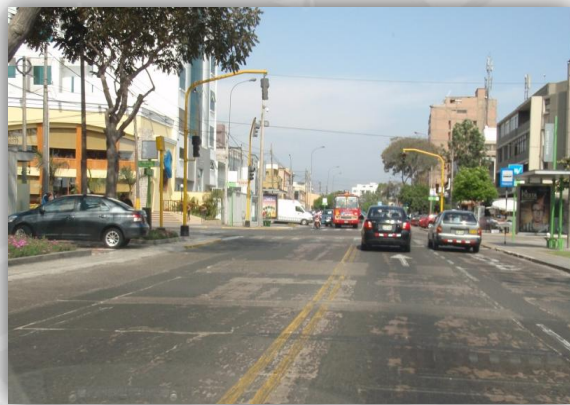
Figura 2.19: Pavimento de la vía sin mantenimiento.
