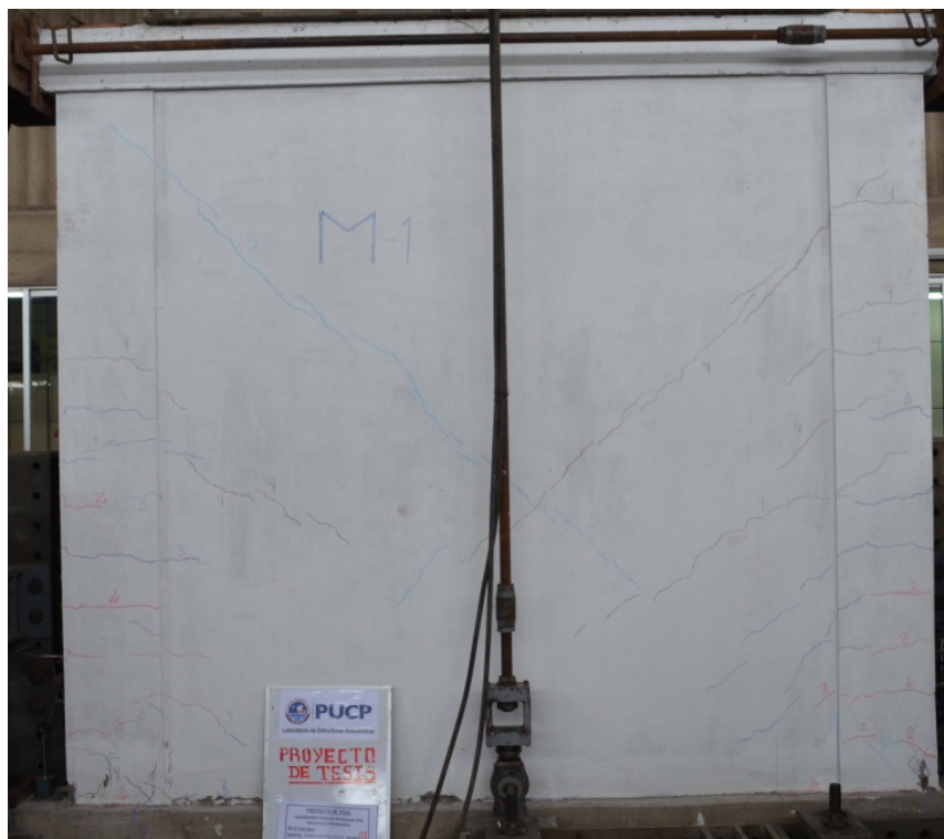
Fig. N° 47: Fisuras horizontales en las columnas y fisuras diagonales en la albañilería – Fase 05 (MR-01).
