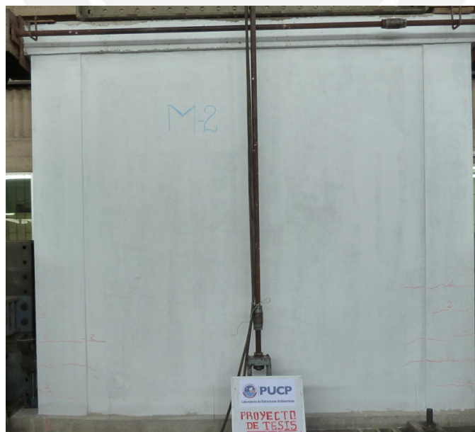
Fig. N° 52: Fisuras horizontales en las columnas y fisuras diagonales en la albañilería – Fase 02 (MR-02).
