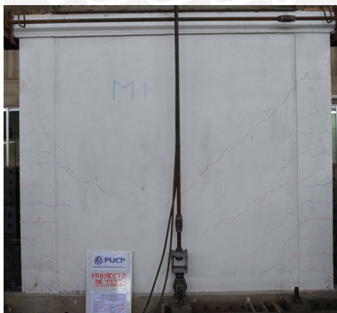
Fig. N° 46: Fisuras horizontales en las columnas y fisuras diagonales en la albañilería – Fase 04 (MR-01).
