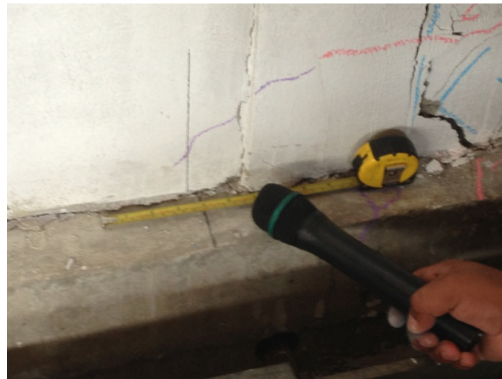
Fig. N° 50: Falla por deslizamiento del muro sobre la viga de cimentación (Longitud=14mm) – Fase 06 (MR-01).
