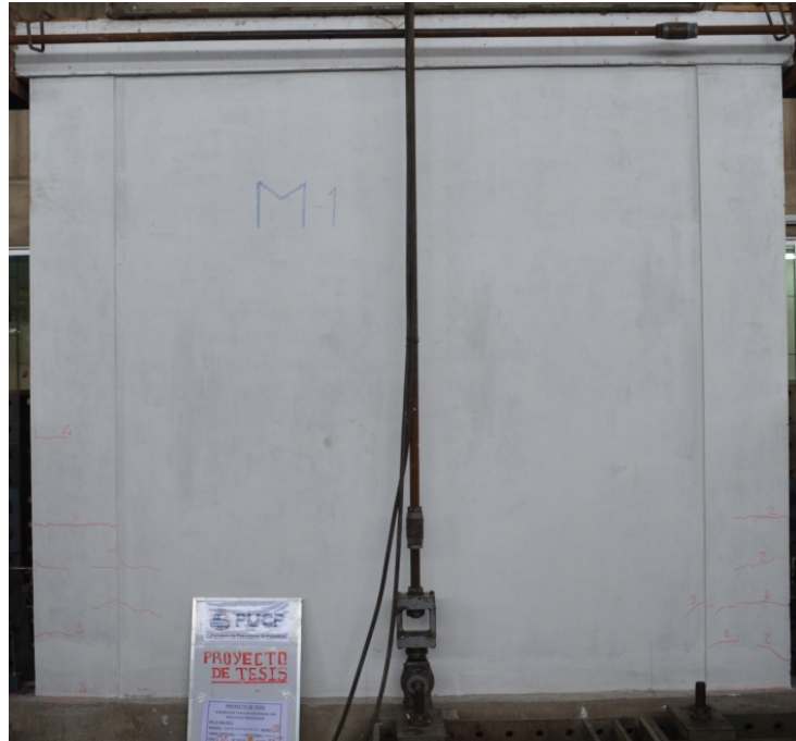
Fig. N° 43: Fisuras horizontales en las columnas – Fase 02 (MR-01).
