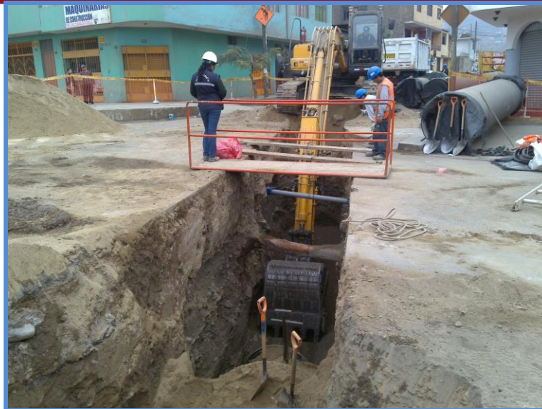
Figura 49: Excavación con interferencia
