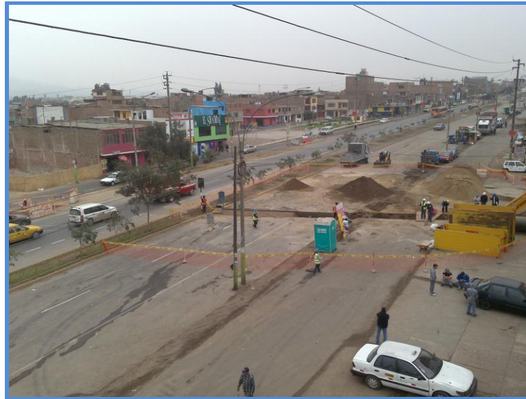
Figura 12: Elementos de seguridad en el cruce de la Av. Túpac Amaru
