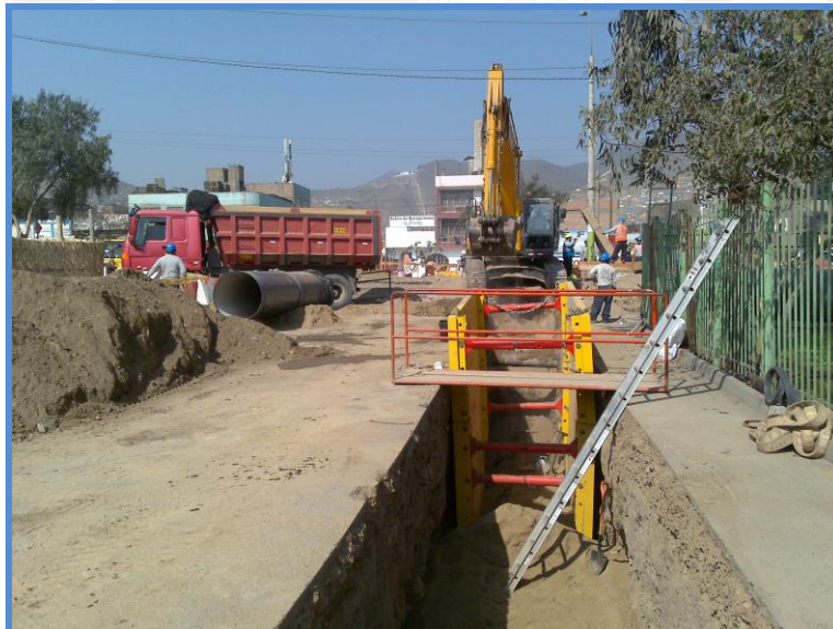
Figura 46: Tubería de DN 1000
