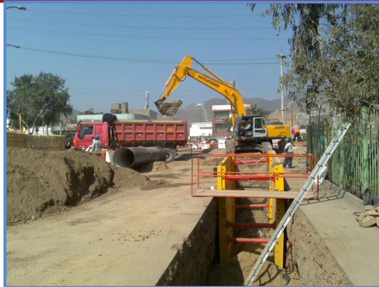
Figura 47: Tubería de DN 1000
