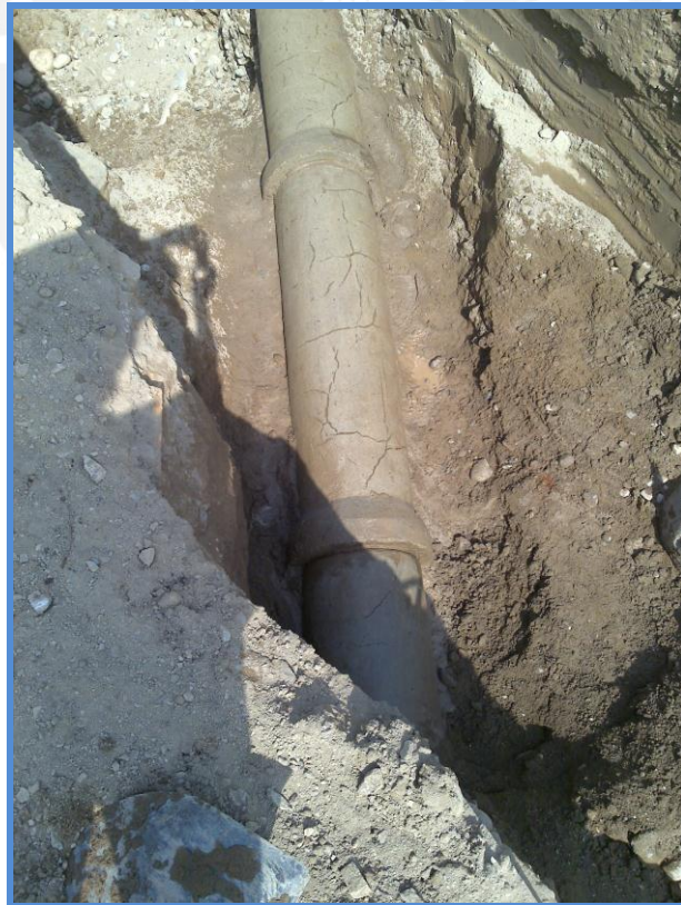
Figura 59: Rajadura de tubería existente
