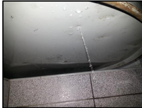
Figura 3.3 Fuga en fondo de Tanque
