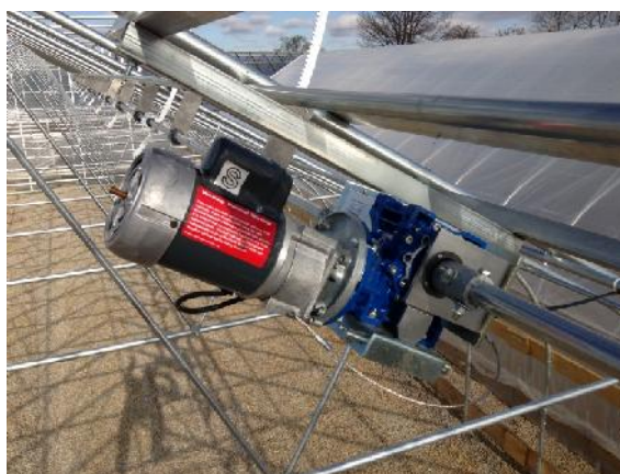
Figura 3.14 Motorreductor ubicado en una ventana cenital
