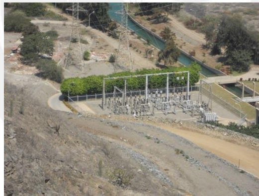
Figura 5. Central hidroeléctrica Gallito Ciego. Fotografía del proyecto DGI 2010.0110
