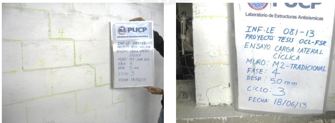
Fig.6.12. Grietas escalonadas en M1 (izquierda) y grietas en talón de M2 (derecha)
