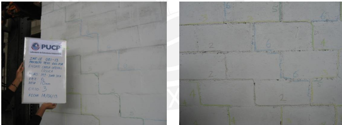
Fig.6.16. Grietas escalonadas en M1 (izquierda) y en M2 (derecha)
