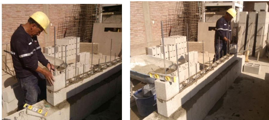
Fig.5.5. Refuerzo horizontal en el eje del muro y bloques maestros en los extremos.
