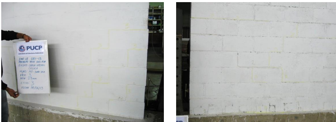
Fig.6.10. Fase 3. Fisuras en los muros M1 (izquierda) y M2 (derecha)
