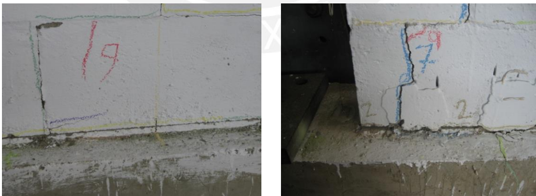
Fig.6.22. Grietas en la base de M1 (izquierda) y grietas en talón de M2 (derecha)
