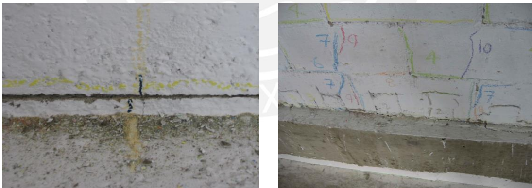
Fig.6.23. Fisuras en la fase 10, M1 (izquierda) y M2 (derecha)
