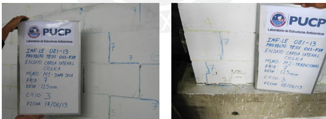
Fig.6.18. Grietas escalonadas en M1 (izquierda) y grietas en talón en M2 (derecha)
