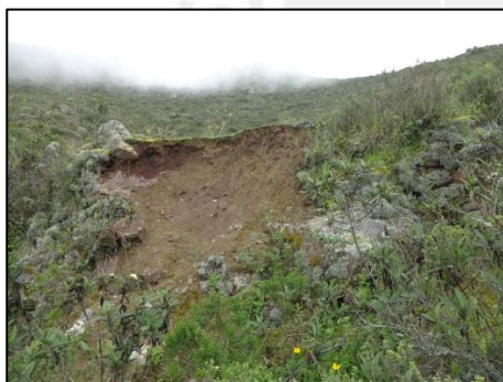
Figura 38: Ejemplo de un muro de un andén abandonado y deteriorado (punto TB-30)
