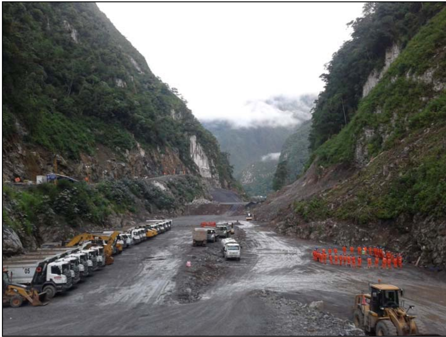
Relleno de presa 10 de enero del 2013, tomado desde el nivel del acceso a la presa que se aprecia a mano izquierda de la imagen, sobre los volquetes parqueados.
