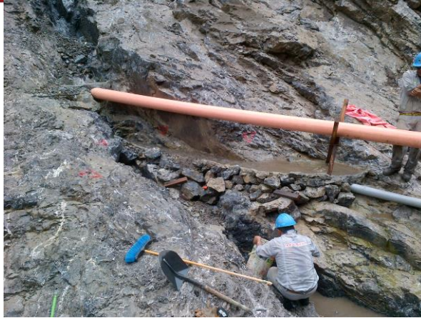
Fig. 4.2. Filtraciones de la ladera en el margen derecho (Fuente: Propia)
