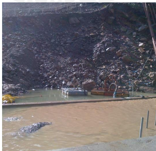
Fig. 4.1. Filtraciones en la ataguía aguas arriba (Fuente: Propia)
