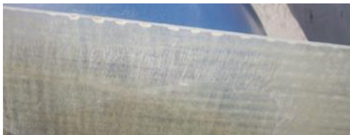
Figura A19: Presencia de delaminación después del corte
