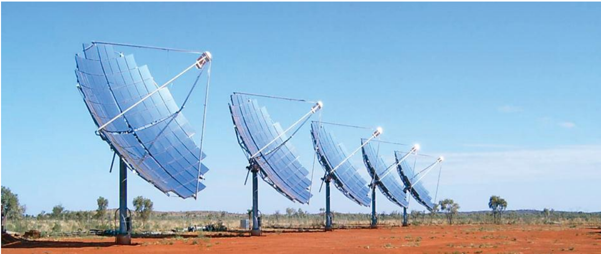
Figura 1.23 Concentrador Solar instalado por Solar Systems en Australia
