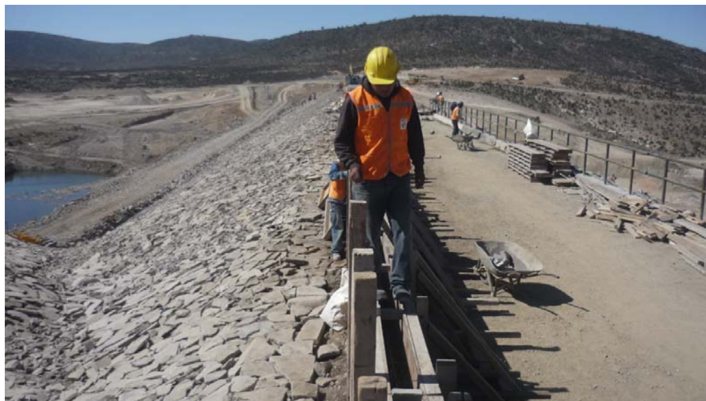
Figura 2.48 Protección de Enrocado Aguas Arriba y vía superior Fuente: Gerencia Regional de Infraestructura (2010)
