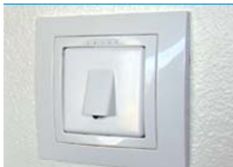
Fig. 4.8-1 Sonda de temperatura instalada
