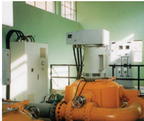
Gráfico N° 36: Vista de Mini Central Hidroeléctrica
