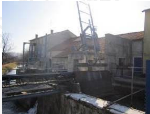
Gráfico N° 4: Central Hidroeléctrica Instalado en Canal de Riego Agrícola - Italia
