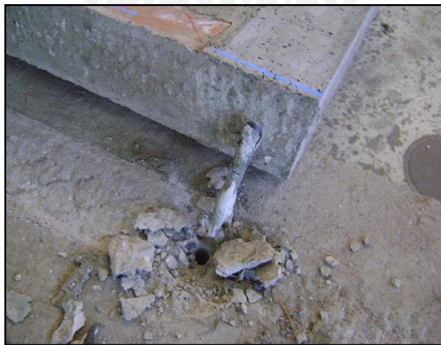
Figura 7.3. Falla por anclaje en M1.
