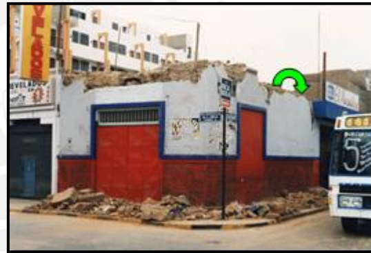
Figura 1.2. Colapso de un parapeto
