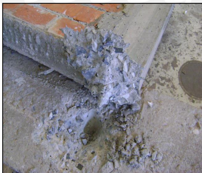
Figura 7.5. Falla por anclaje en M3.
