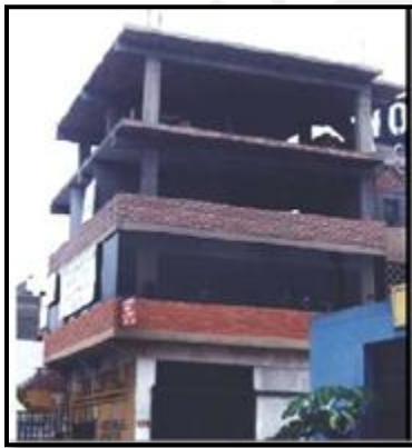
Figura 1.1. Parapeto no reforzado
