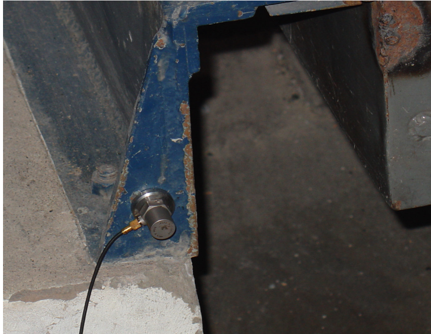
Fig. A1.4 Acelerómetro conectado a un Apoyo de la Chancadora de Quijada y Preparado para Recibir señales de Desplazamiento en el Eje Y.
