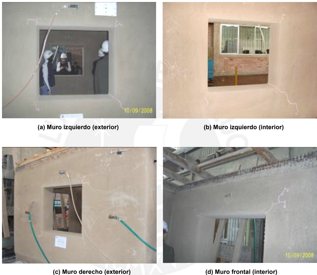
Figura 7.5. Daños en el módulo M100-T4100 – Post Fase 2 (80mm)
