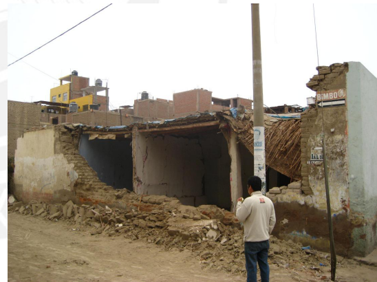
Figura 1.3. Colapso parcial de una vivienda de adobe tras el sismo de Pisco (Fuente: Hulburd, 2008)
