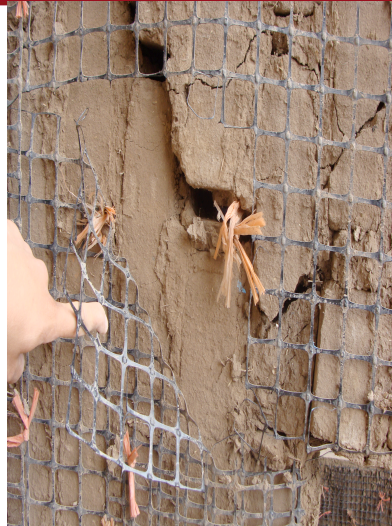
Figura 7.14 Rotura de geomalla exterior en la esquina inferior izquierda del muro izquierdo
