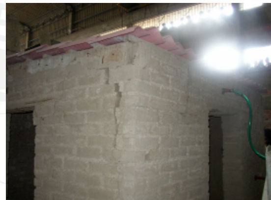
(b) Encuentro entre el muro derecho y frontal
