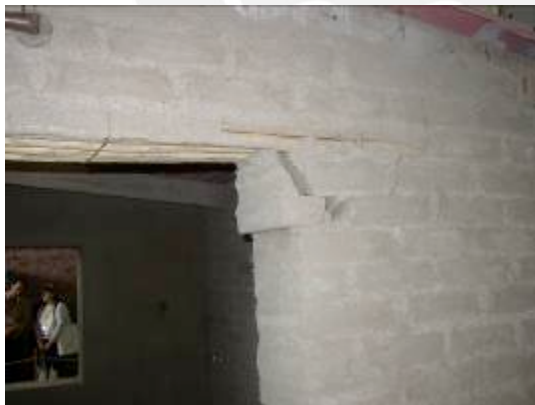
(c) Daños en la ventana del muro izquierdo
