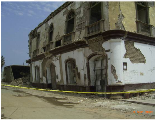
Figura 1.2. Vivienda de adobe y quincha afectada por el sismo de Pisco (Fuente: EEFIT, 2008)
