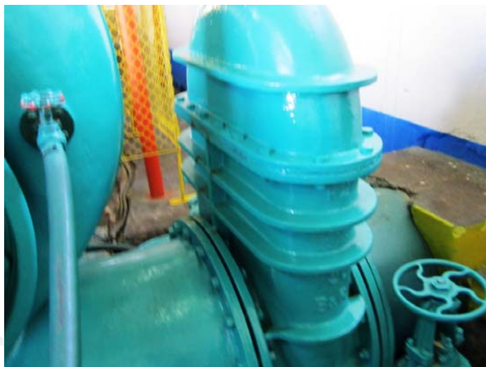
S1. Vista general de la válvula de admisión manual tipo compuerta a reemplazar [Material propio]
