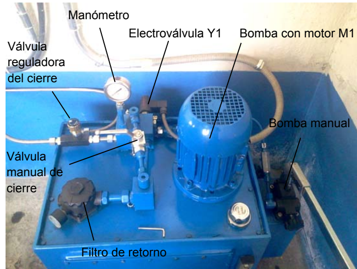
S13.Vista de la unidad de presión con algunos componentes principales [Material propio]
