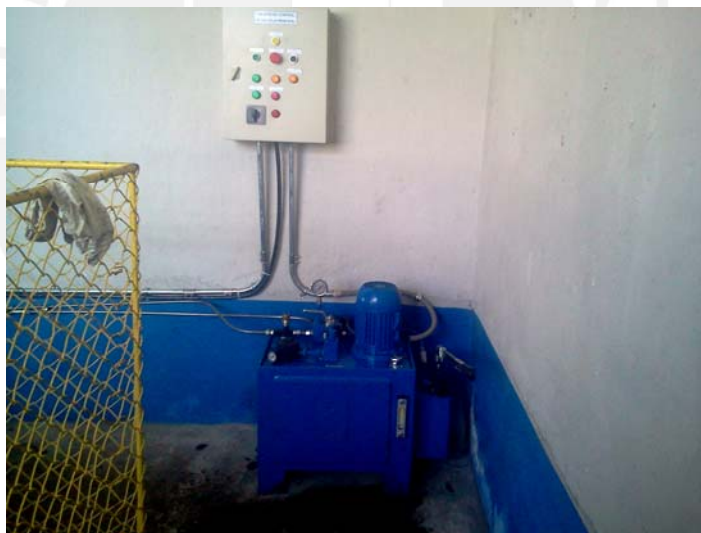
S12. Vista del tablero de control y la unidad de presión [Material propio]
