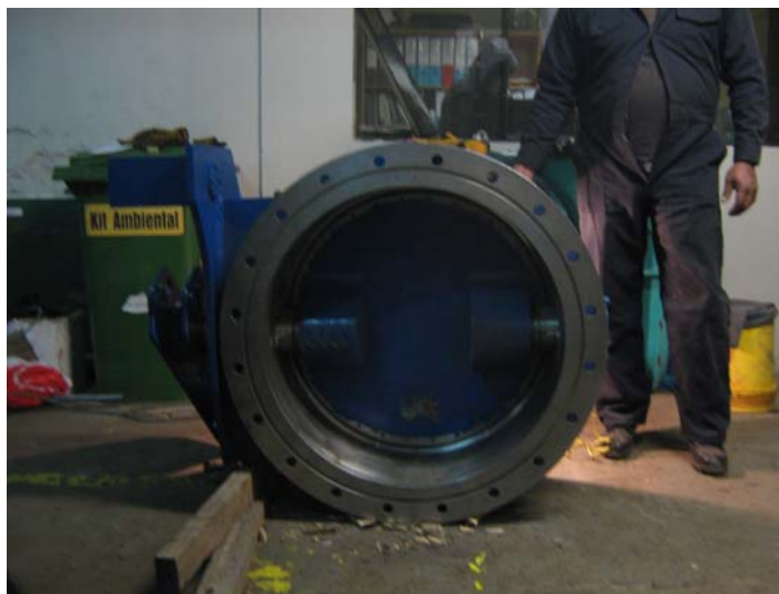
S5. Vista de la nueva válvula de admisión tipo mariposa en posición cerrada [Material propio]
