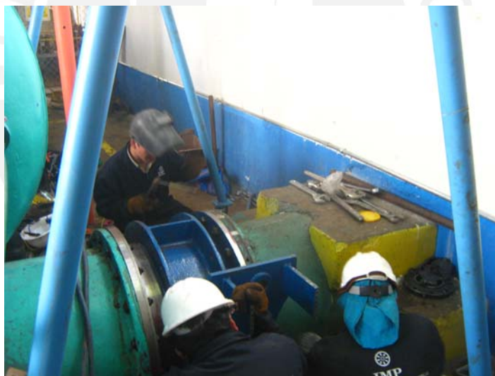
S8. Instalación de la nueva válvula de admisión tipo mariposa [Material propio]
