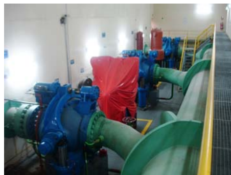
Figura 1.6. Válvulas de admisión tipo esférica de la central Matucana (Material propio)
